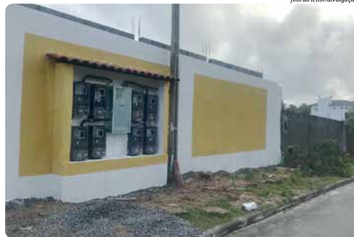
Casas já tem até contador de energia, mesmo sem alvará de construção
